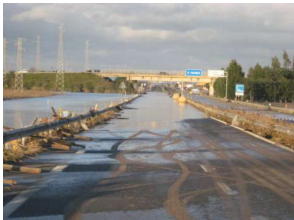
Allagamento della S.S. 106 Jonica in sponda sinistra del Fiume Bradano marzo 2011
